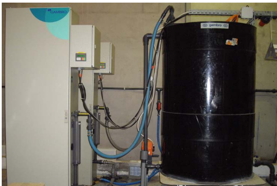
Figure 25 : Osmoseurs et cuve de stockage
