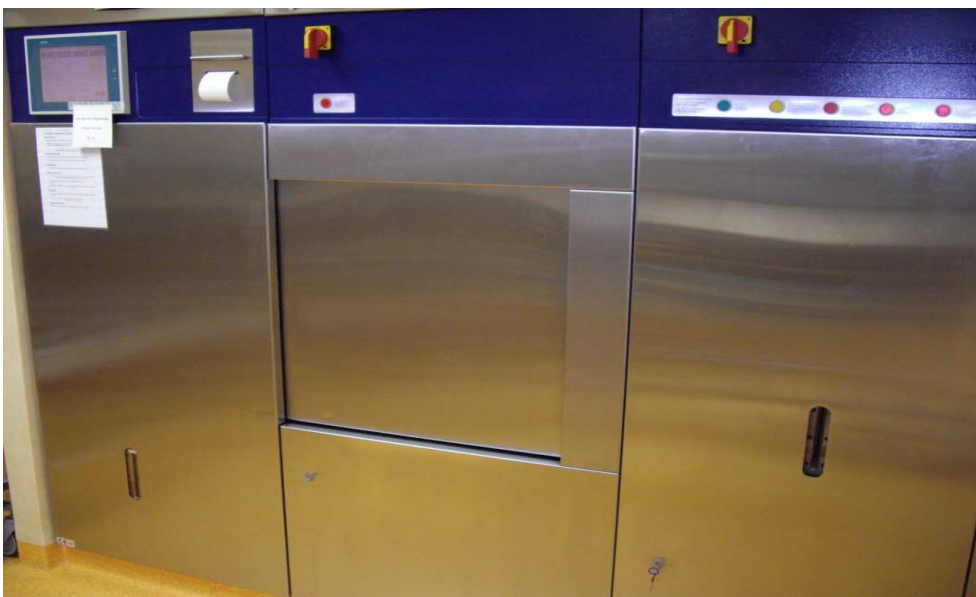
Figure 22 : Stérilisateurs Schaerer ASD8 en cours de fonctionnement
