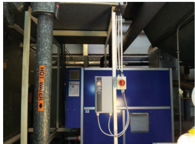
Variateur du moteur d'extraction
