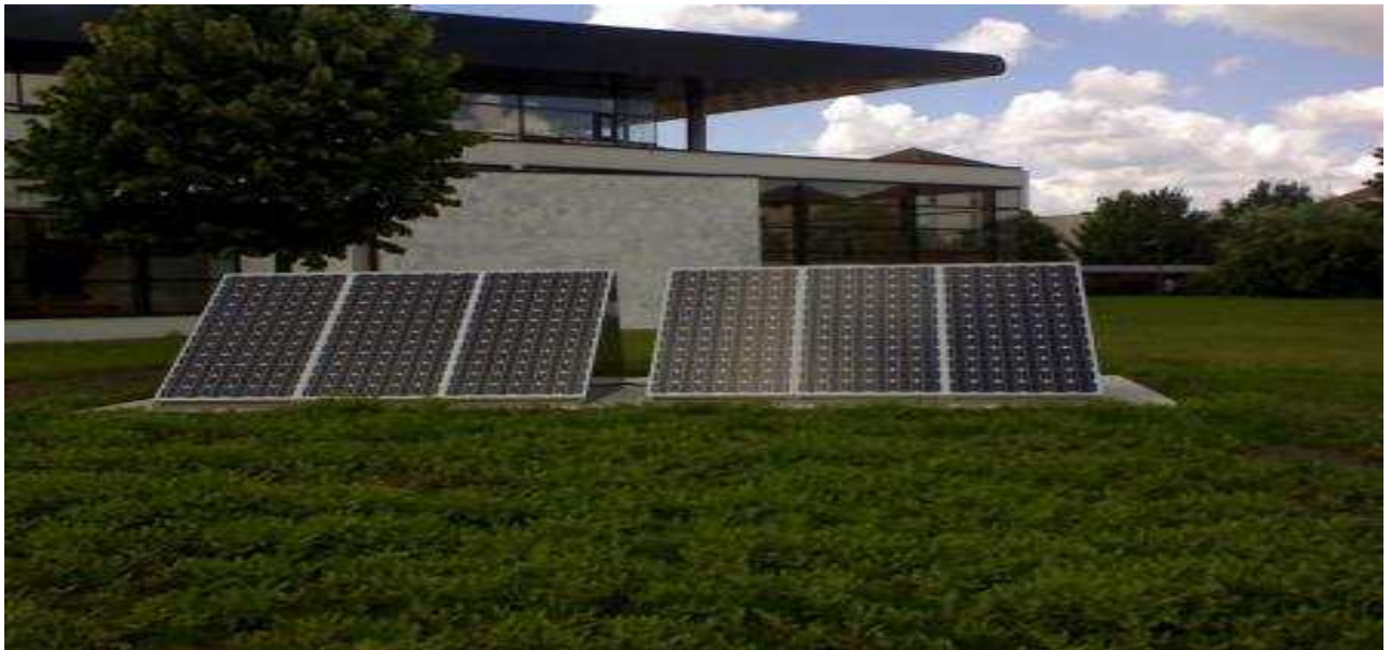
Fig. 4.2. Installation panneaux PV à l'ENSEM Nancy
