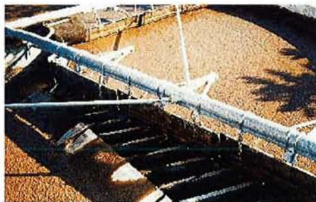
Figure I.5. Epaississement des boues par flottation
