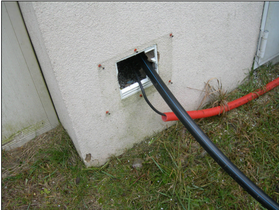
Photo c : Passage des conduites d'eau du nouveau forage par l'aération
