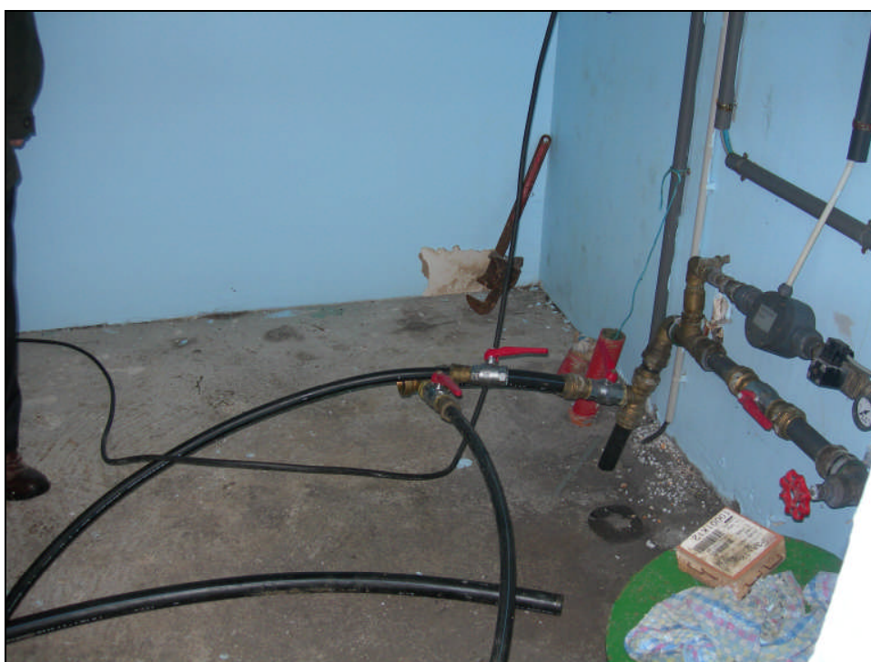
Photo c : By-pass permettant l'alimentation en eau du réservoir par le forage F
