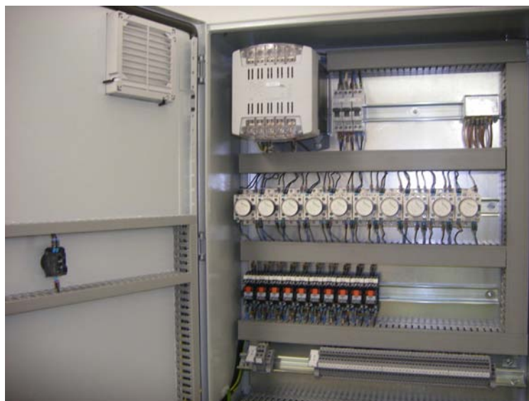
Figure 10 : Coffret de désenfumage
