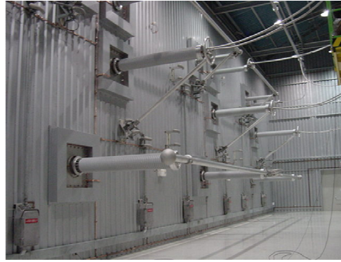
b) Connexions des transformateurs dans le hall des redresseurs
