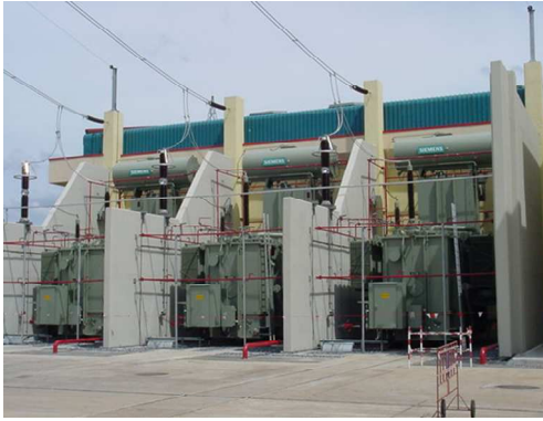
a) Transformateurs monophasés
