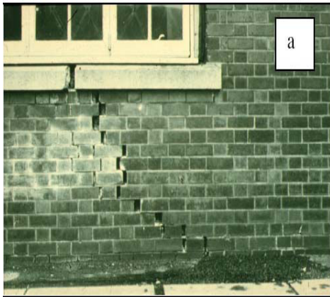
(a) : Rupture engendrée par extension-cisaillement
