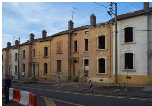
Figure 13. Dommages directs aux habitations de la rue de Metz à Auboué après l'affaissement minier de 1996 (Source : Gisos)
