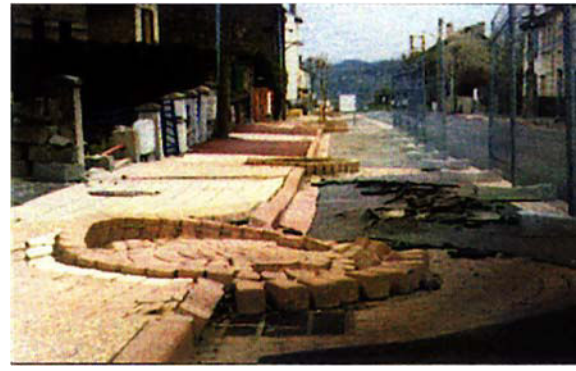
(b) : Rupture de la chaussée (photo : Ineris)
