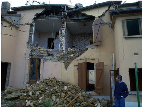
(a) : Dommages sur une maison de la rue de Metz (photo : Gisos)
