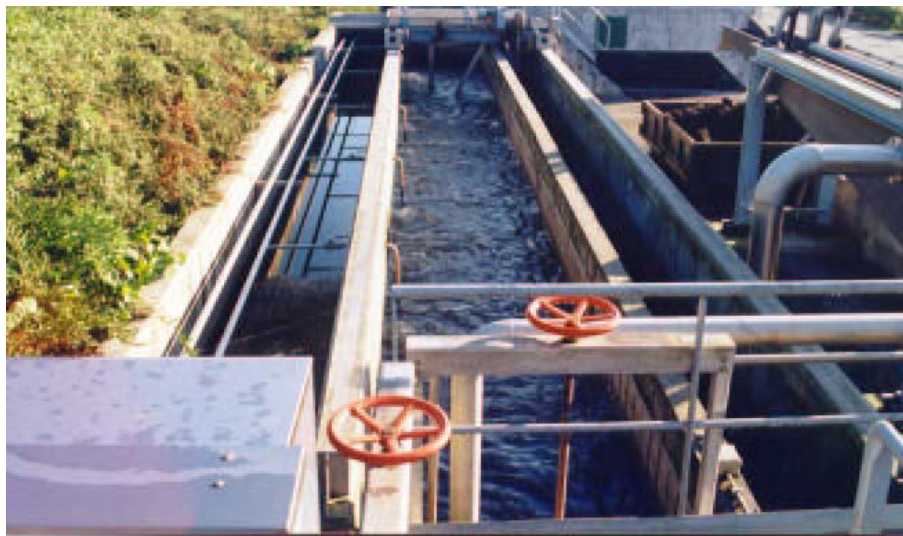
FIG. A.5 – Unité de desablage
