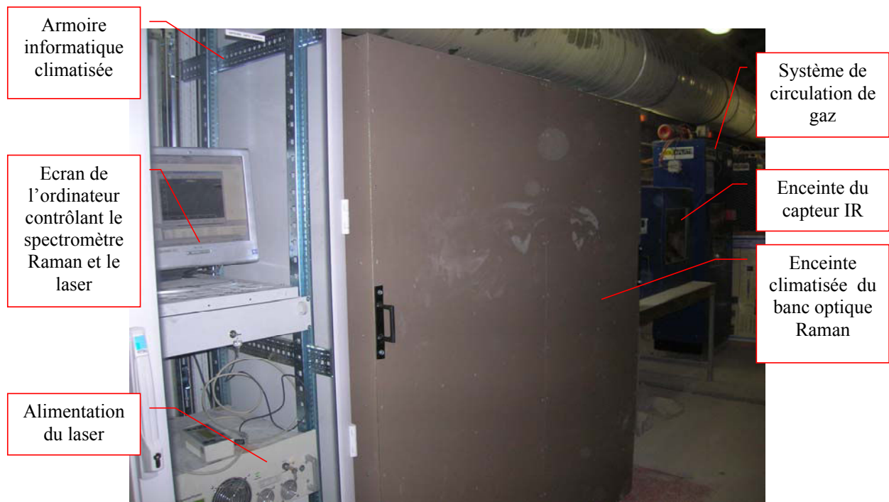
Figure 4.7 : Vue de la zone PAC1002 constituée du banc optique Raman, de l'armoire informatique Raman, du capteur IR et du module de circulation et de prélèvement de gaz (laboratoire de Meuse/Haute-Marne -490 m).
