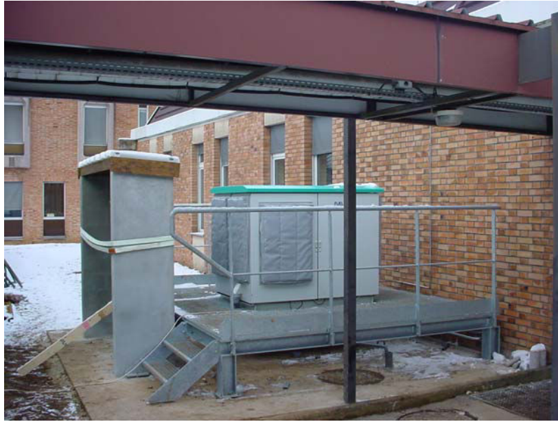
Figure 1.7 : Unité de Pile à combustible RCU-4500 installée à Nancy.
