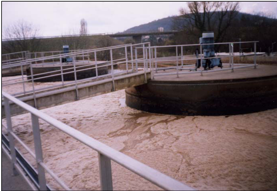
Figure n°1.1.2 : Bassin biologique (station d'épuration de Toul (54))
