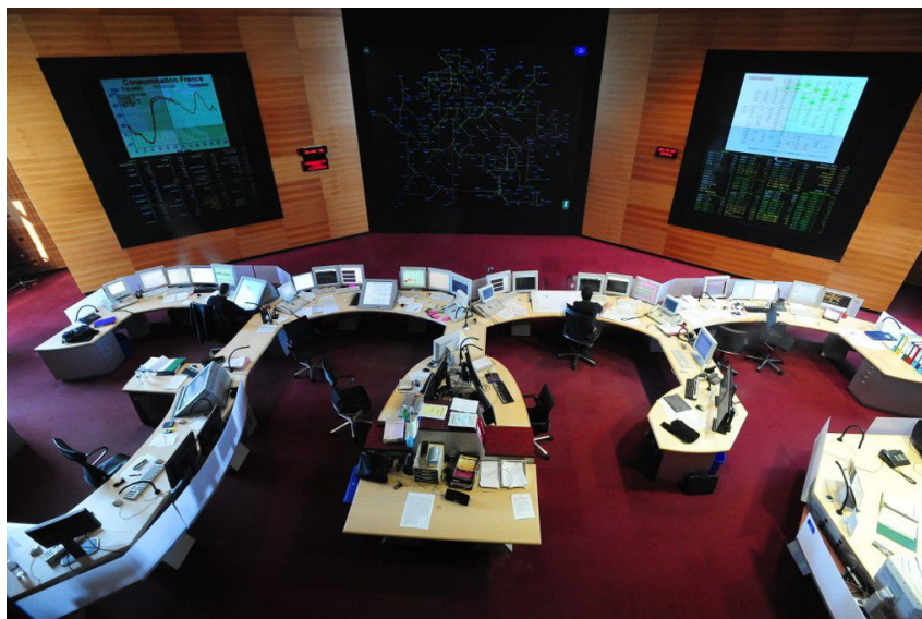
FIGURE 1.5 – Une salle de conduite ou dispatching français. Chaque opérateur, dénommé dispatcher , dispose d'un pupitre composé d'un grand nombre d'écrans. Un écran synoptique sur le mur de la salle face pupitre est également partagé entre les opérateurs.
