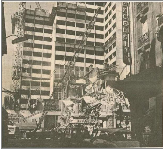
Document 50: Démolition des derniers bâtiments, (Est Républicain, 1997 l'anniversaire de la première pierre)
