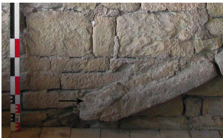
Fig. 20 – Joint d'étanchéité conservé sur le solin du bas-côté nord de Vomécourt-sur-Madon, 88 (cliché Cédric Moulis).
