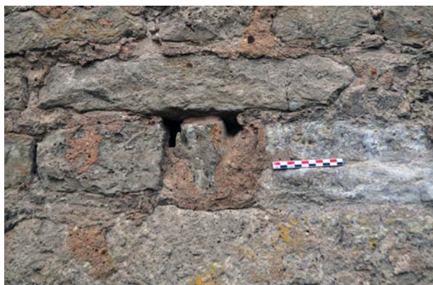
Fig. 20 – Trou de boulín maçonné, bouché grossièrement et tardivement, église de Flin, 54 (cliché Cédric Moulis).
