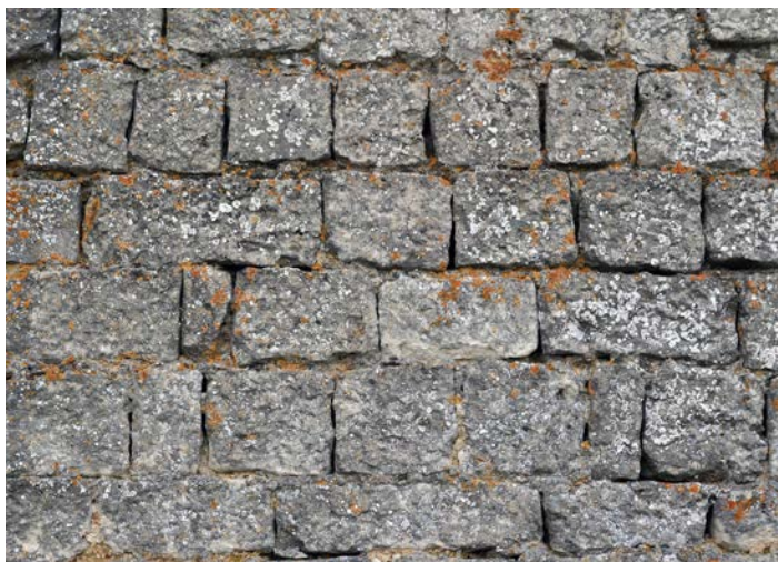
Fig. 15 – Appareillage de pierres de taille calcaires dégrossies au pic, sans taille de finition, sur le mur gouttereau nord de l'église de Battigny, 54 (cliché Cédric Moulis).
