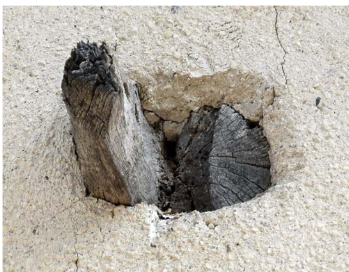
Fig. 5 – Extrémité d'un entrail de la charpente romane de l'église d'Allamps (54). On devine un assemblage à tenon-mortaise et deux trous de cheville à gauche (cliché Cédric Moulis).
