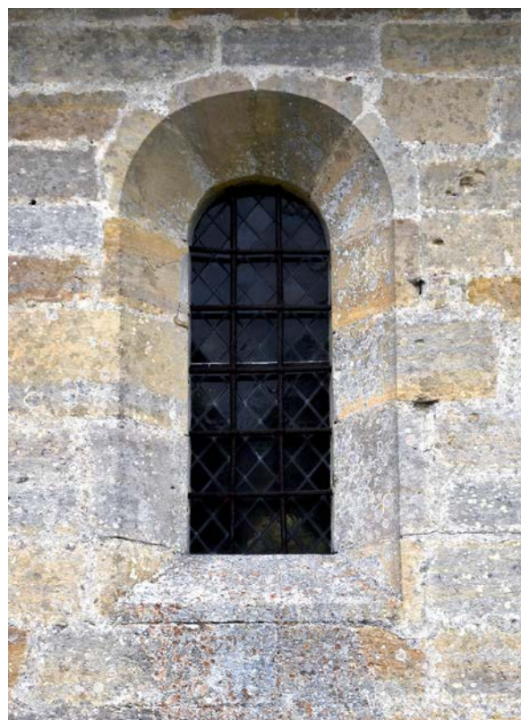
Fig. 26 – Arc composé de quatre voussoirs, sans clef d'arc, église de Couvonges, 55 (cliché Cédric Moulis).
