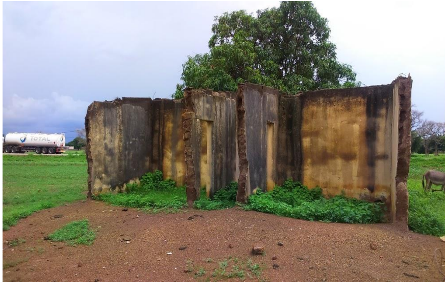
Photo 113 : Ruines de salles de classe construites à Poa-centre par les Amis de Sabou avec du chaume vers les années 80, et qui n'ont pas pu résister à l'épreuve du temps et du climat. (Source : Willy MOUNDEMBA, le 12 août 2016)
