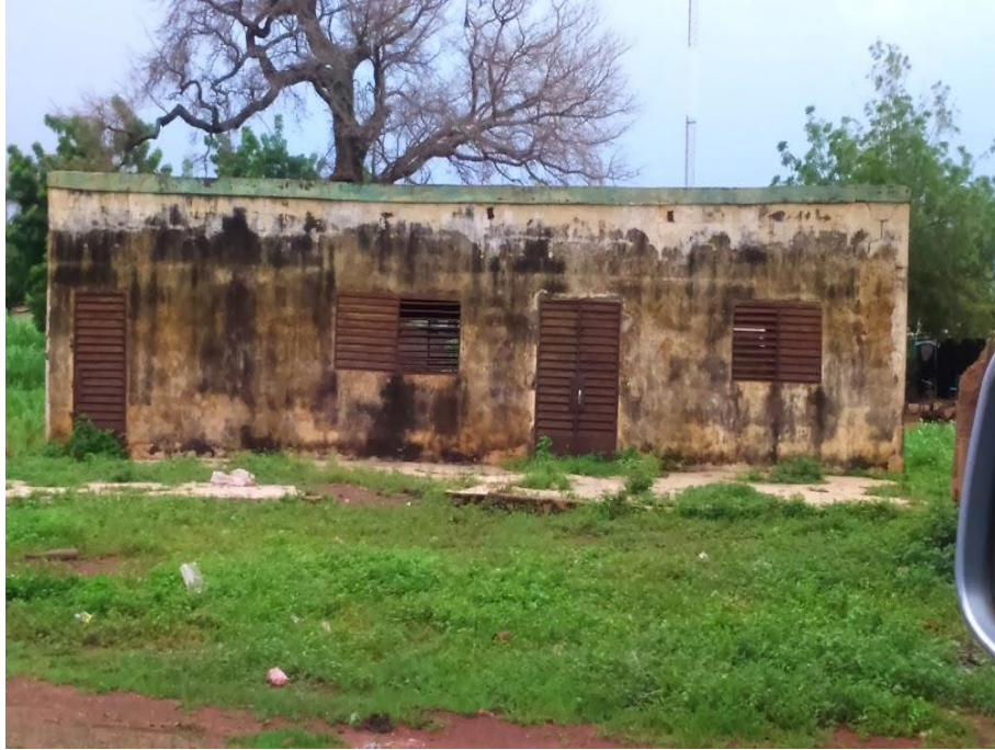
Photo 114 : l'ancienne Maison des Jeunes de Poa construite aux premières heures de l'Association, à Poa-centre. Le bâtiment situé à moins de 5 mètres du bitume est parfois utilisé. (Source : Willy MOUNDEMBA, 12 août 2016)
