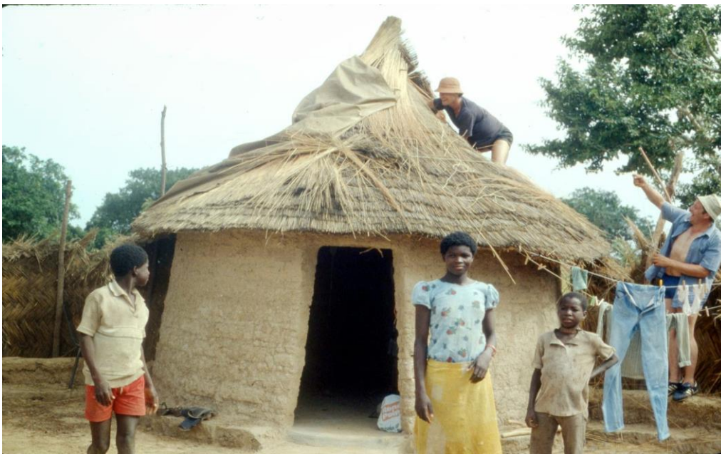
Photo 23 : Pascal LAURENT réparant la case de Sylviane, (Source : Pascal et Sylviane LAURENT, 1982)
