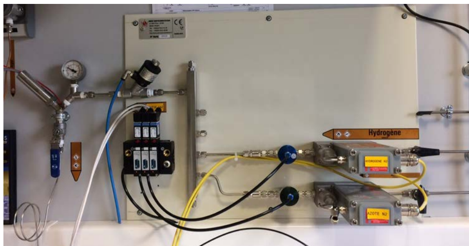
FIGURE 4.26 – Photo de l'installation d'arrivée de gaz.
