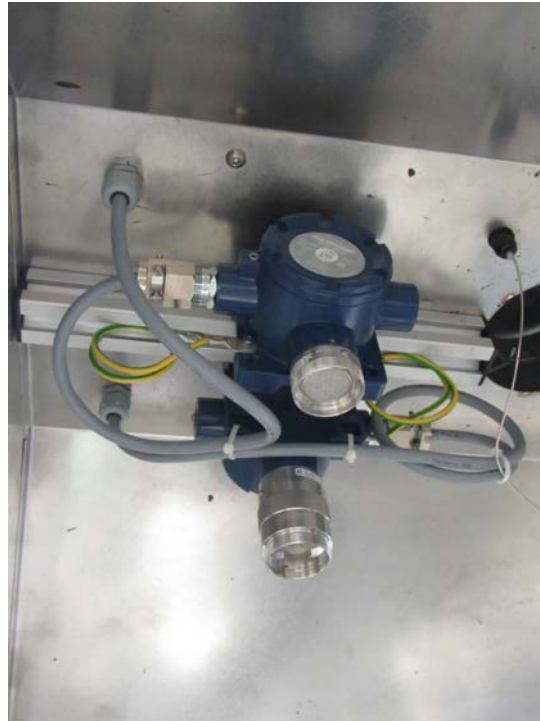
FIGURE 4.32 – Détecteurs de gaz placés dans la hotte.
