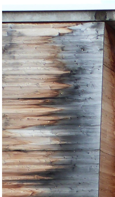
FIGURE 1.21 – Grisaillement non-uniforme d'une façade en contreplaqué lié à une fuite d'eau en toiture
