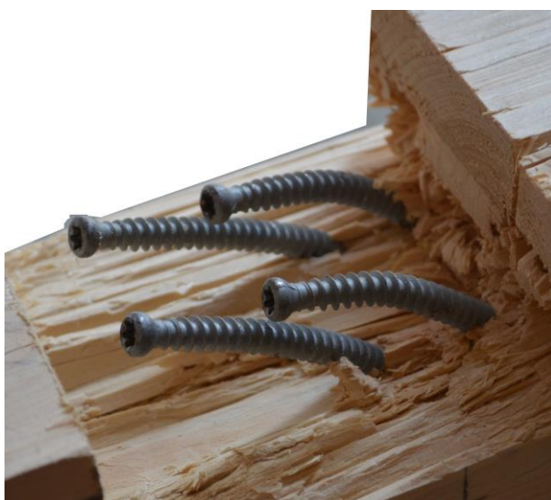
Figure III-110 : Flambement des vis sous appuis
