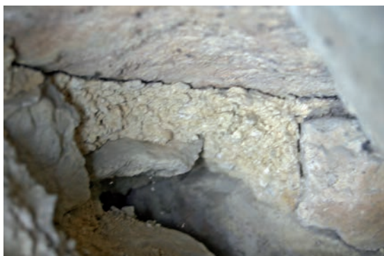
Fig. 400: Liant au coeur de la maçonnerie entre la porte et la fenêtre du 5 e niveau, salle 9
