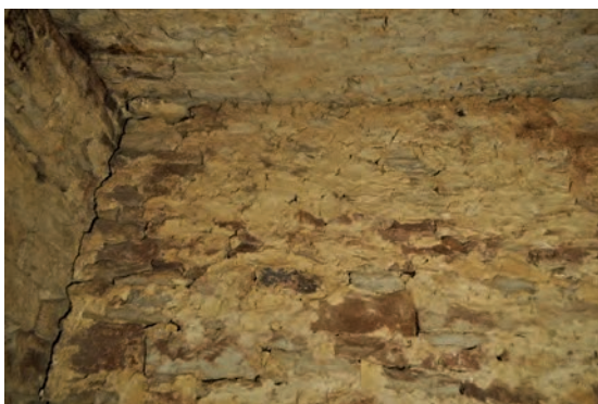
Fig. 94 : Jonction de l'UM8, du mur sud et de la voûte
