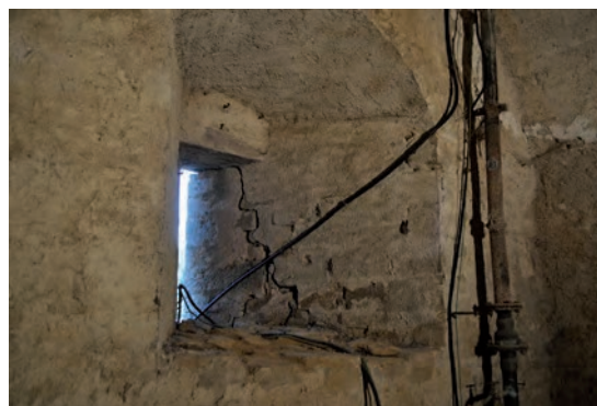
Fig. 71 : Fissure à l'arrière des blocs de l'encadrement extérieur (ébrasement nord)
