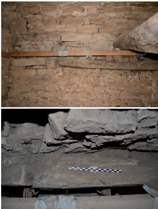
Fig. 327 : La sablière est mal insérée dans la maçonnerie (extrémité est et aplomb)
