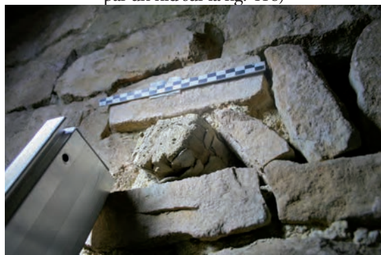
Fig. 421: Détail de la mise en oeuvre du boulin UM5-5-UC7 et emplacement de l'objet (en rouge)
