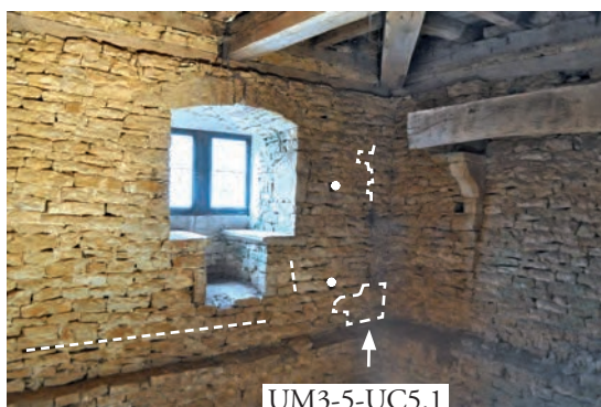
Fig. 386: Irrégularités du parement à l'angle nord-est
