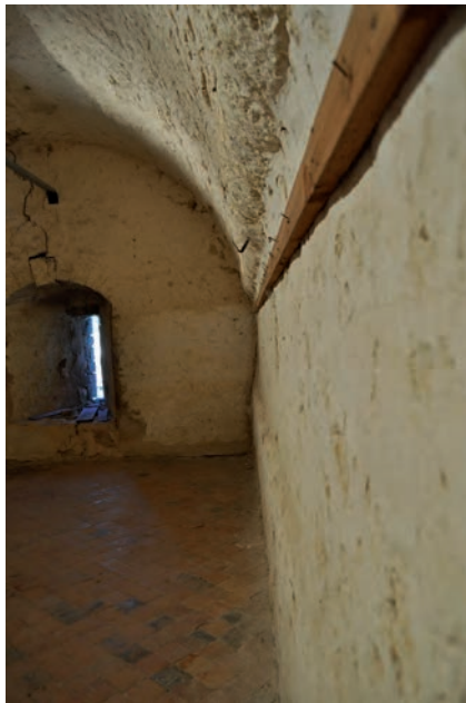
Fig. 142: Vue de profil du mur nord avec un léger retrait à 0,95 m de hauteur
