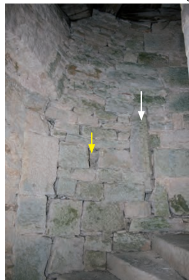
Fig. 399: Jonction entre la porte et la fenêtre. La flèche blanche indique le piédroit de la fenêtre, la jaune la zone d'observation du liant.
