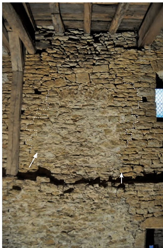
Fig. 407: Conduit de cheminée obstrué (UM3-5-UC1)
