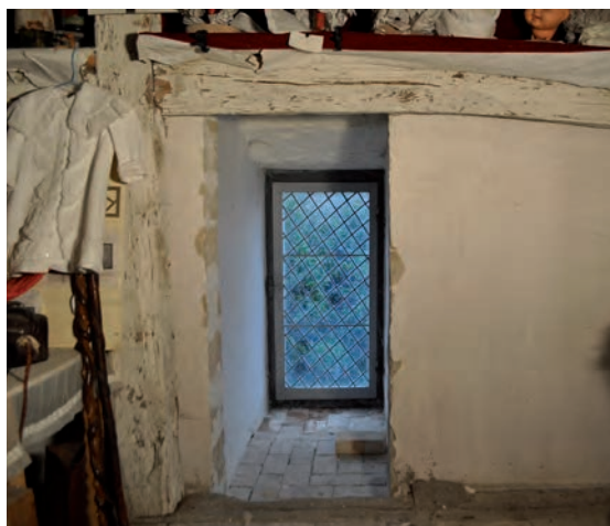
Fig. 260: Coup de sabre dans le mur nord
