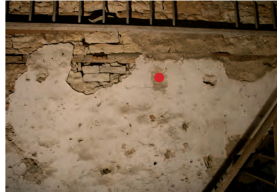
Fig. 222 : Enduits et empochements sous la sablière
