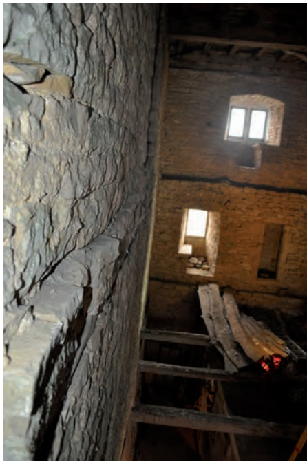
Fig. 434: Ressaut au niveau des empochements, à l'ouest
