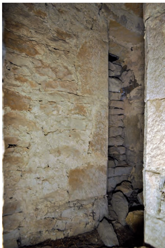
Fig. 373: Détail du mur est (UC1.2) à l'angle vers la partie en encorbellement
