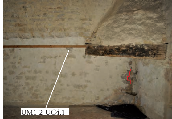
Fig. 155: Mur sud (en rouge, une fissure)
