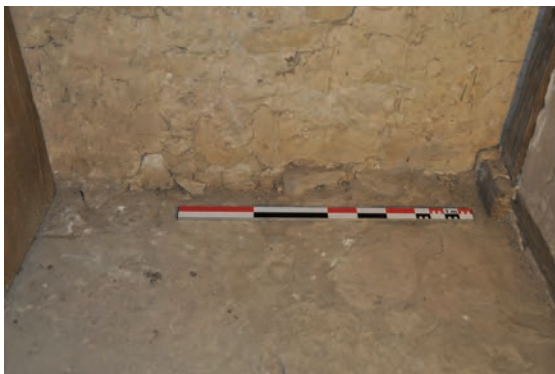
Fig. 259: Coup de sabre dans le mur nord
