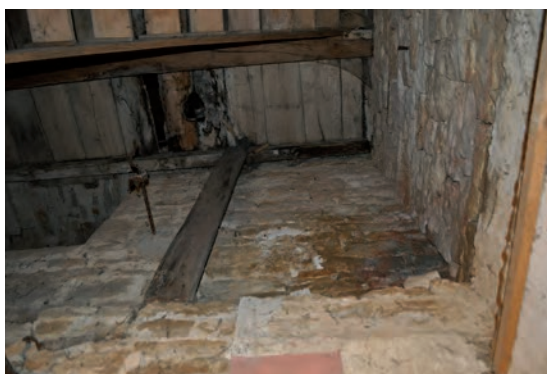
Fig. 210: Effet de paroi au 3 e niveau et vestiges de plâtre dans l'alignement au 4 e niveau
