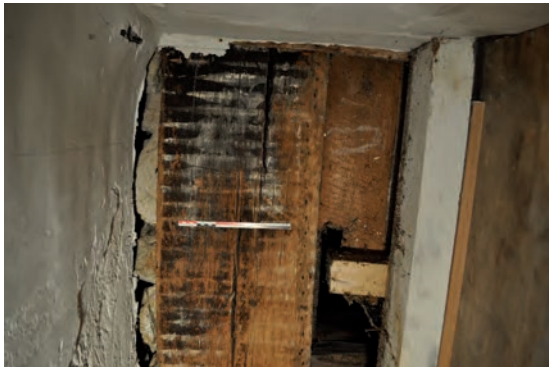
Fig. 279: Poutre de bois comblant aujourd'hui le conduit (localisé en rouge sur la fig. 278)
