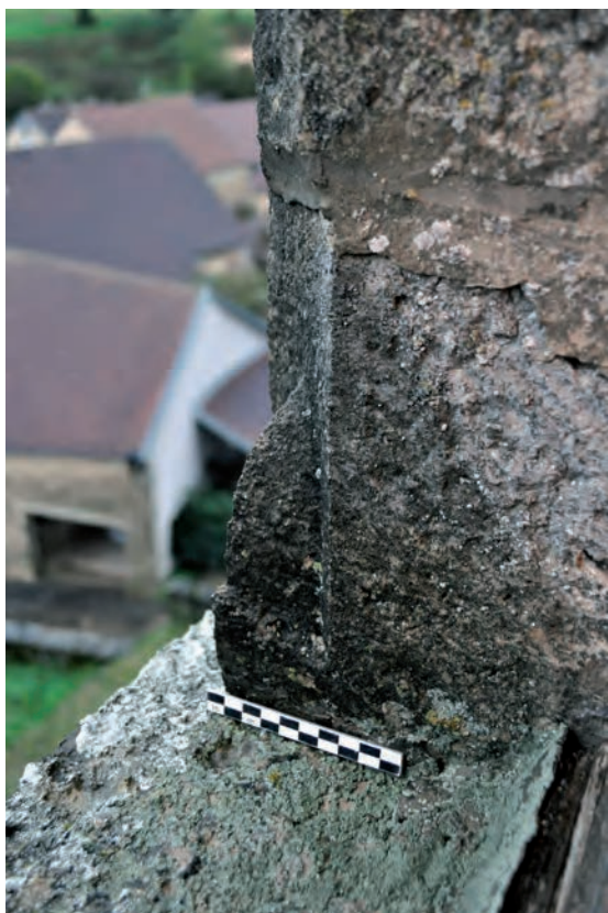
Fig. 272: Détail du congé du piédroit ouest
