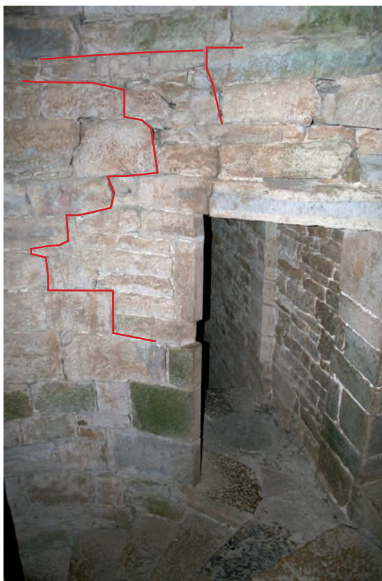
Fig. 178 : Porte et mur de cage entre la tourelle d'escalier et l'escalier intrapariétal
