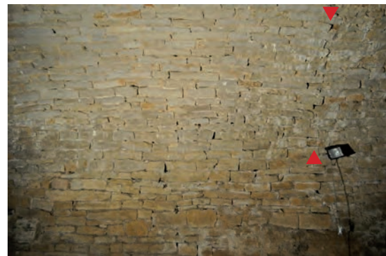
Fig. 60 : Fissure orientale de la voûte, salle 1
