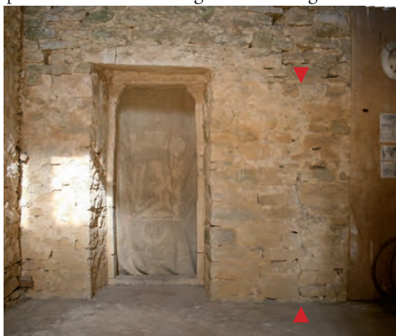
Fig. 256: Coup de sabre dans le mur nord
