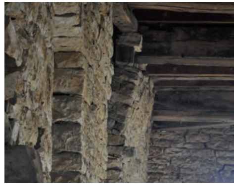
Fig. 459: Sommet du piédroit occidental, en déversement
