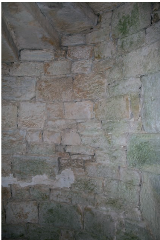
Fig. 307 : Maçonnerie du mur de cage à l'est du piédroit de la porte (à droite sur le cliché)
