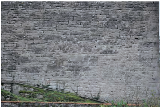
Fig. 39 : Parement rejointoyé au sud du 1 er niveau e la façade occidentale (UM2-UC2)
