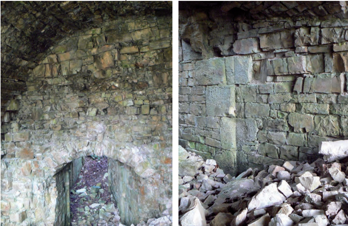
Fig. 12 : Ouverture entre la salle voûtée sud et le vestibule et détail du montant oriental de ce passage
