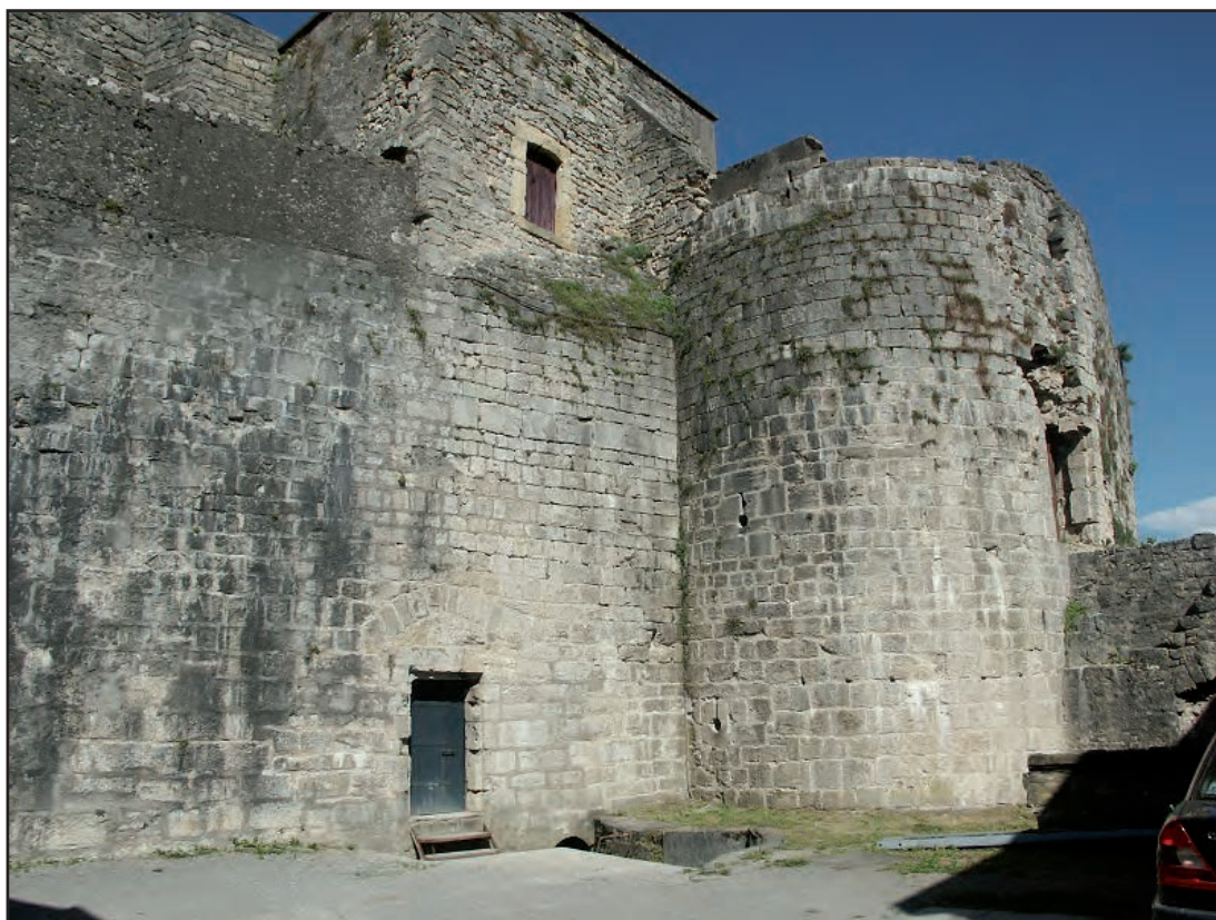
Fig. 13 : Vue de la jonction entre la chemise d'artillerie, le pignon du corps de logis et l'enceinte de la ville (cliché C. Moulis)
