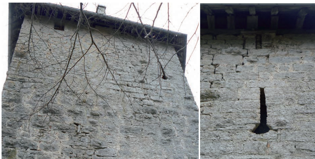
Fig. 19 : Détail du parement nord-ouest de la tour pentagonale et détail de l'archère-canonnière au 4 e niveau
