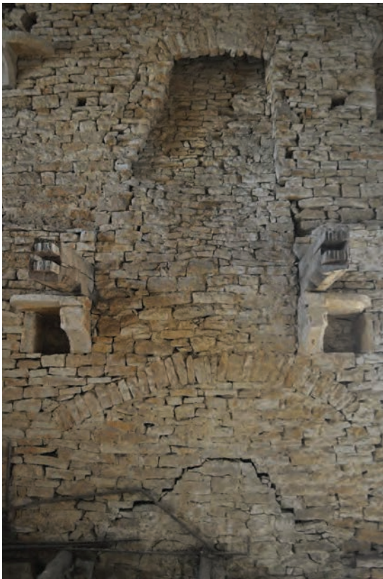
Fondremand, à gauche 4 e niveau, mur sud ; dessous, 5 e niveau angle nord-ouest
