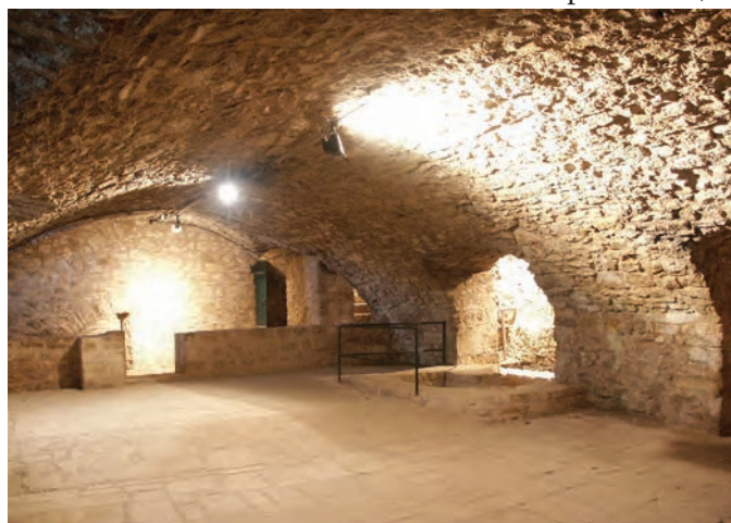
Fig. 83: Salle voûtée voisine de la boulangerie, à l'arrière-plan (cliché C. Moulis) Position indiquée par un point rouge sur les documents ci-dessus
