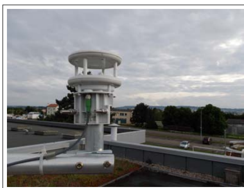
FIGURE 4.11 – Photographie du capteur WS200-UMB installé sur le toit du Laboratoire Régional de Nancy pour la mesure de la vitesse et direction du vent à 2 m par rapport à la surface de la toiture végétalisée.
