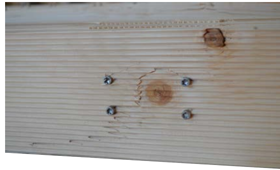
(b) Poutre 5 : rupture à un nœud
