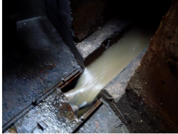
Figure III. 25 : Passage des eaux usées en temps sec vers la STEP.
