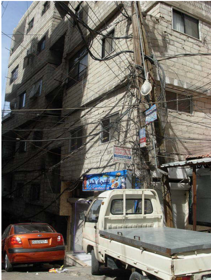
Cliché 44 : Incroyable fouillis des branchements électriques à Mazzé 86. Les branchements clandestins sur les réseaux d'électricité dans les quartiers non réglementaires, comme ici à Mazzé 86, forment un inextricable faisceau de centaines de fils électriques, ce qui peut causer des coupures de courant ou même des accidents. Cliché : Main KAFA, Mars 2010.
