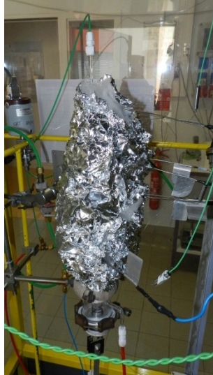
Figure 11 : Photo du RAC calorifugé
