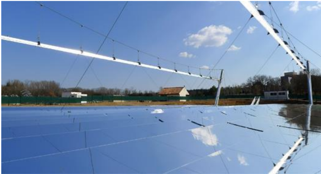
Centrale solaire thermodynamique à miroirs de Fresnel
