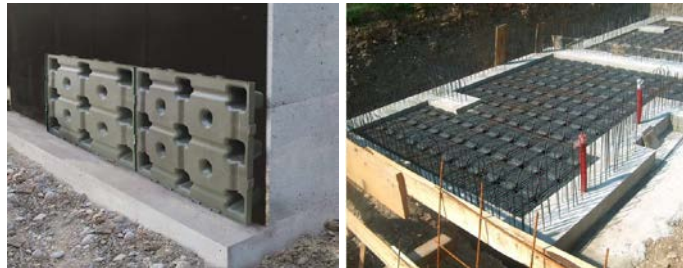
Figure 17 : Photographie des plaques isolantes issues du recyclage des big-bags.
