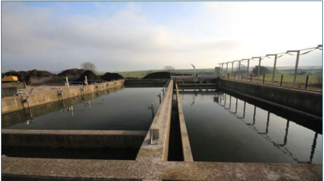
Figure 6 : Station de Laître sous Amance (bassin biologique et clarificateur)
