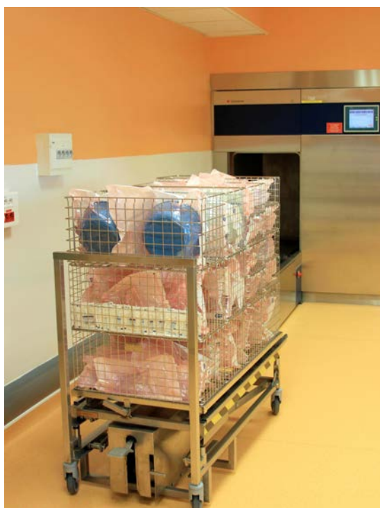
Figure 17 : Sortie des caissettes après stérilisation, de l'autre côté du stérilisateur à deux portes
