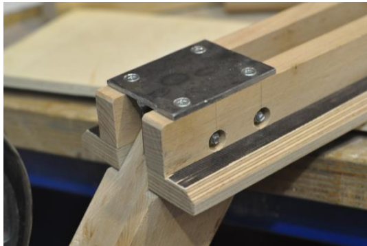
Figure 35 : Mise en place de l'âme métallique entre la plateforme et le lien
